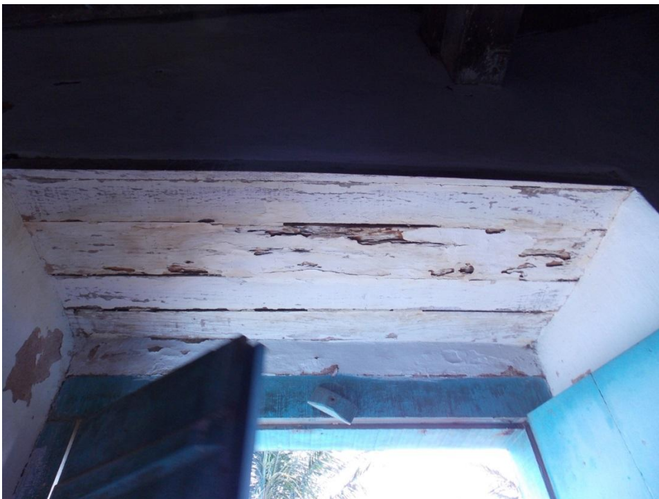
Fotografia 07 – Candida Muñoz - Retalho da janela da galeria em estado de deterioração.
