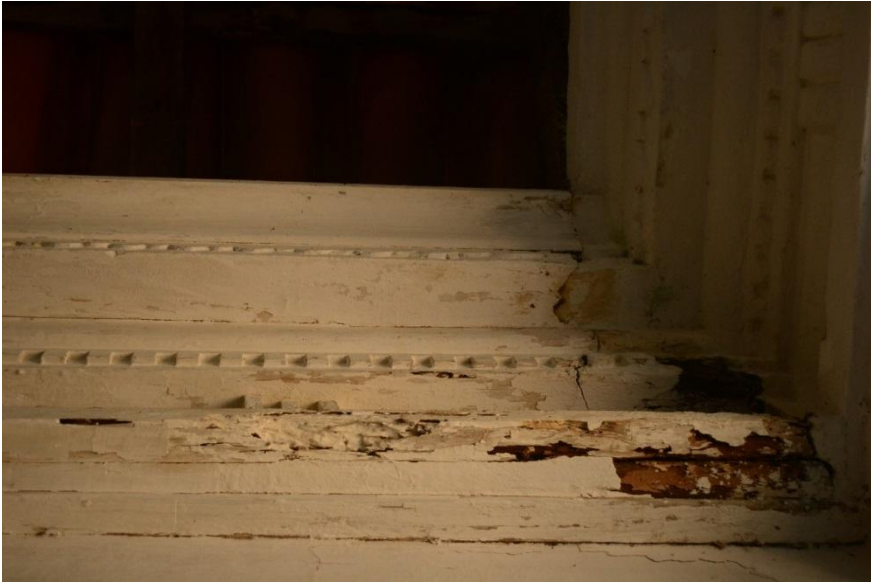
Fotografia 08 – Candida Muñoz - Retalho da estrutura da galeria tomada por cupins
